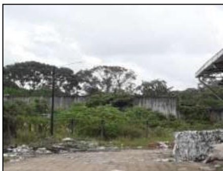
Foto 21: Cerca de aço deteriorada.
