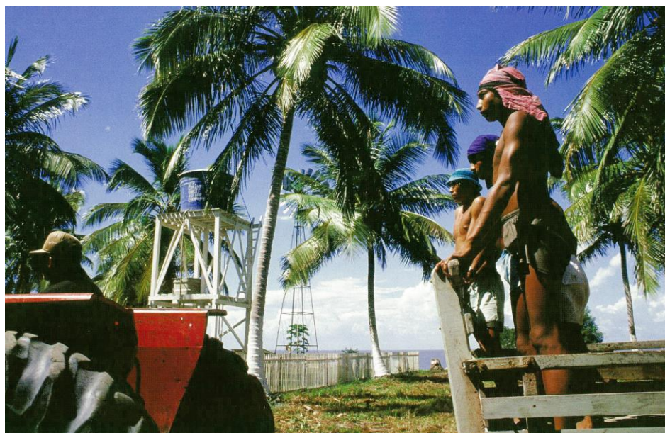
Imagem - 04: Praia Grande, Ilha de Marajó, festa de inauguração do sistema de água potável janeiro de 1993.
